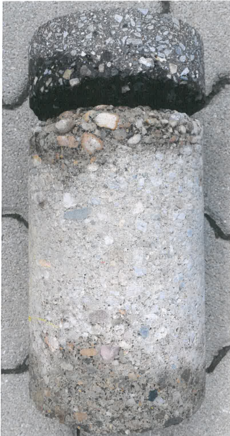
4. kép: Fúrás minta Nyíregyháza, Bocskai utca 29-31. szám telekhatár előtt tengelytől 2,1 m nyomvonal helyreállítás felett
